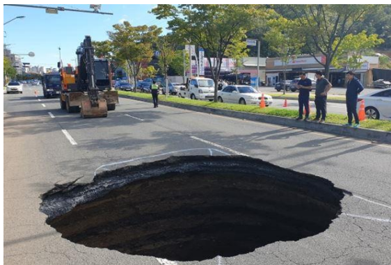
싱크홀 발생 (뉴스1)
